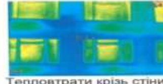
Тепловтрати крізь стіни в місцях розташування опалювальних приладів
