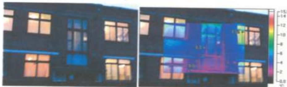
Рисунок 3.11 - Тепловтрати через не ущільненість віконних стиків ззовні в приміщенні 46
